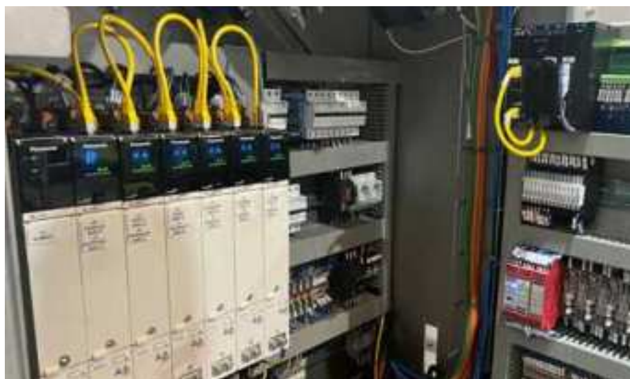
Obr. 2.: Pohled do rozváděče stroje
