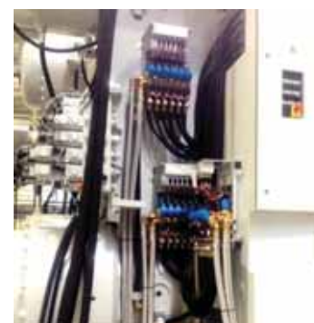
Obr. 2: Na pevné i pohyblivé desce stroje je namontováno po 18 ventilových blocích víceokruhového temperačního systému HAHN PulseTemp RPT 200. Jednotlivé chladicí okruhy jsou se vstřikovacím nástrojem propojeny prostřednictvím rychloupínacích desek
